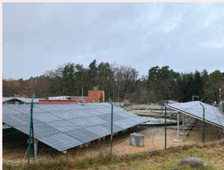
Solaranlage am Klärwerk Amelinghausen
